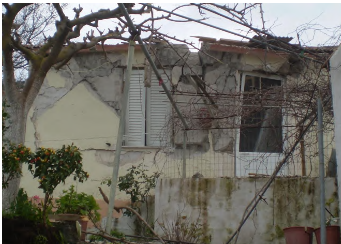
Φωτογραφία 9-1. Εκτεταμένες αστοχίες σε οικία μετά τον σεισμό του 2014 στην Κεφαλονιά (πηγή: Προσωπικό αρχείο πολιτικού μηχανικού Ηλία Αναστάσιου.)
