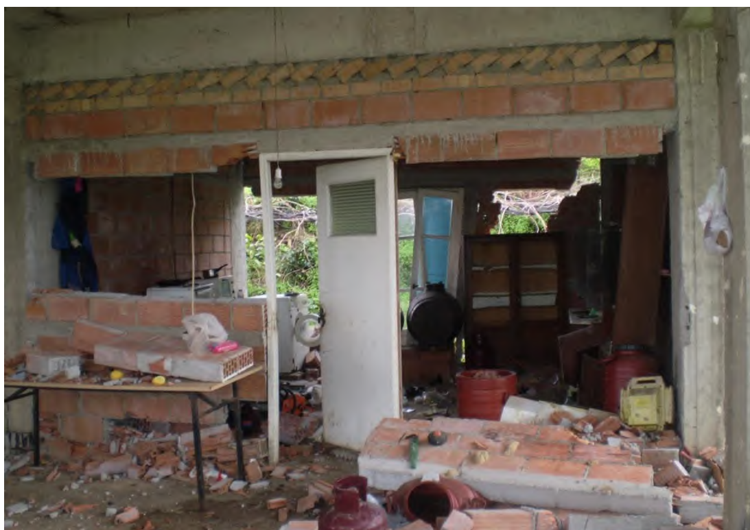
Φωτογραφία 6-1. Αποκόλληση και πτώση εσωτερικής τοιχοποιίας (2014, Σεισμός Κεφαλονιά, πηγή: Αρχείο Ηλία Αναστάσιου, Πολιτικού Μηχανικού MSc.).
