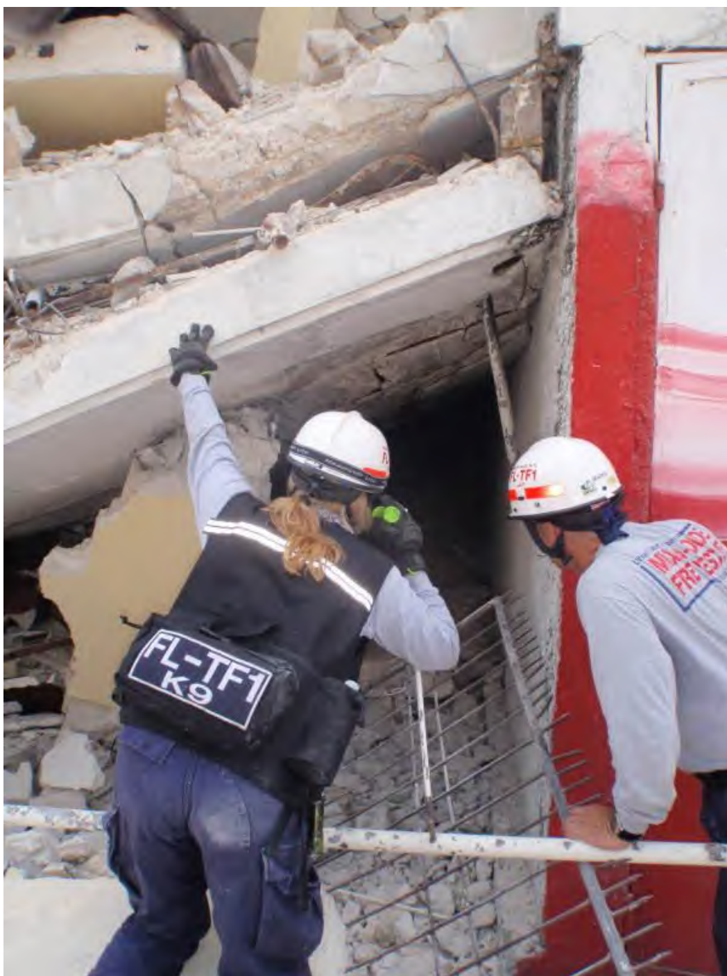
Φωτογραφία 7-1. Σημείο στήριξης πλάκας-δοκαριού, σε περίπτωση κατάρρευσης τύπου V. Στην συγκεκριμένη φωτογραφία είναι εμφανής η εκτεταμένη βλάβη της πλάκας στη στήριξή της με το δοκάρι και συνεπώς η ανάγκη υποστύλωσής της. (2010, Σεισμός Αϊτής, πηγή: State Archives of Florida, Florida Memory, Miami-Dade Fire Rescue.- FL-TF 1 .)
