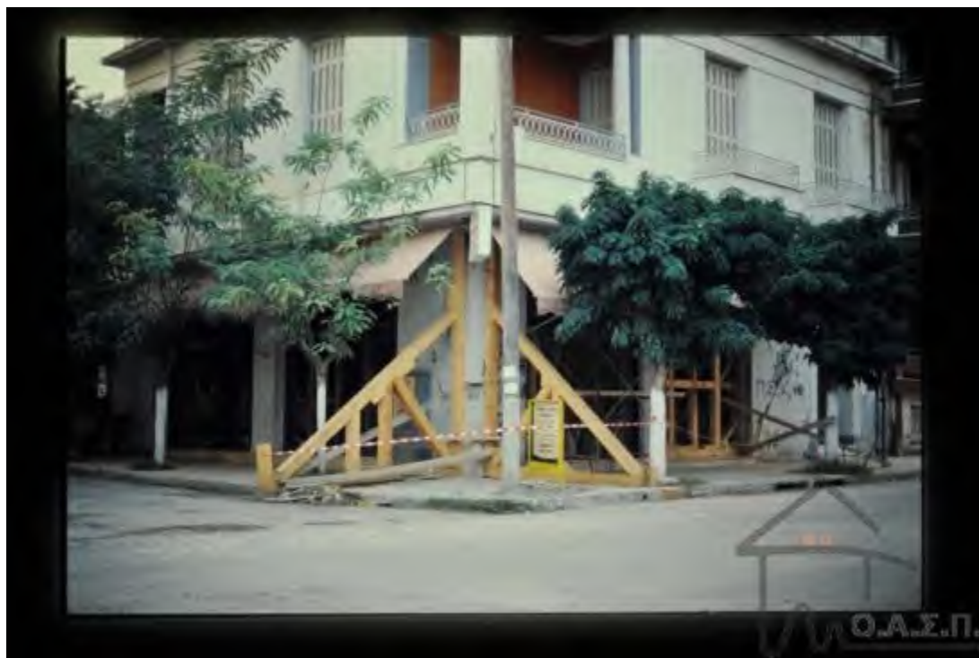
Φωτογραφία 1-3. Υποσύλωση γωνιακής κολώνας (1986, Σεισμός Καλαμάτα, πηγή: Φωτογραφικό Αρχείο Ο.Α.Σ.Π.).
