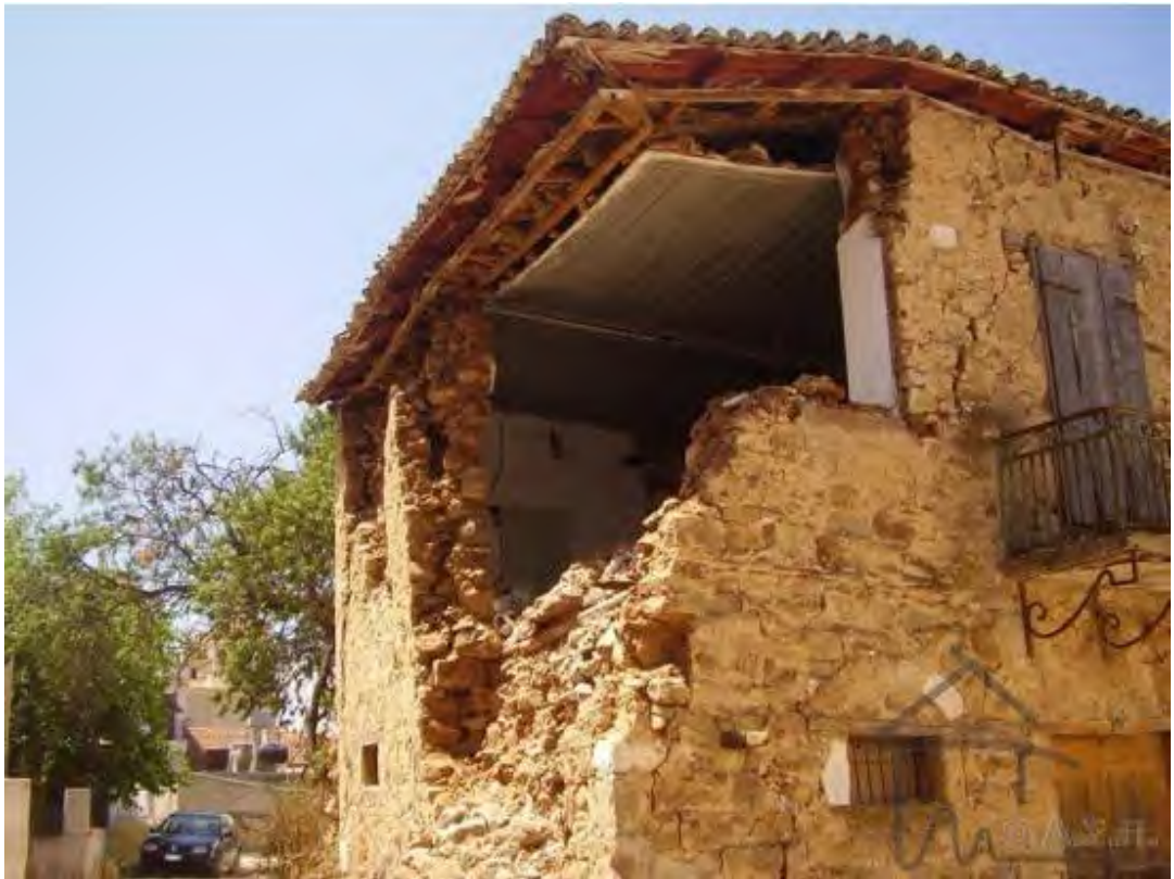
Φωτογραφία 1-1. Κατάρρευση δίστρωτης τοιχοποιίας (πηγή: Φωτογραφικό Αρχείο Ο.Α.Σ.Π.).
