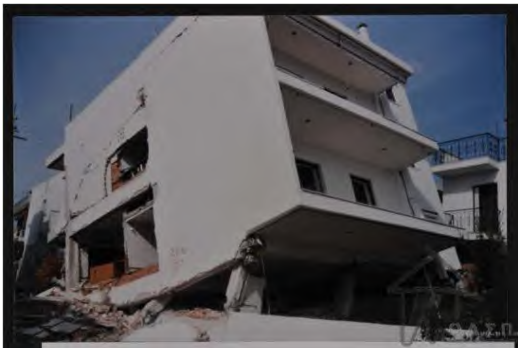
Φωτογραφία 6-7. Εκτεταμένη αστοχία στο ισόγειο - πυλωτή, η οποία έχει οδηγήσει σε κατάρρευση του κτιρίου. (Σεισμός 1999 Αθήνα, πηγή: Φωτογραφικό Αρχείο Ο.Α.Σ.Π.)
