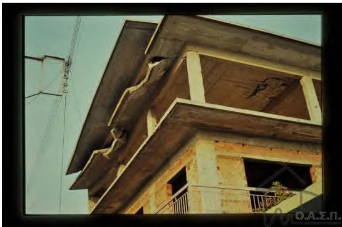
Φωτογραφία 6-12. Εκτεταμένες αστοχίες μπαλκονιών. (Σεισμός 1986, Καλαμάτα, πηγή: Φωτογραφικό αρχείο ΟΑΣΠ)
