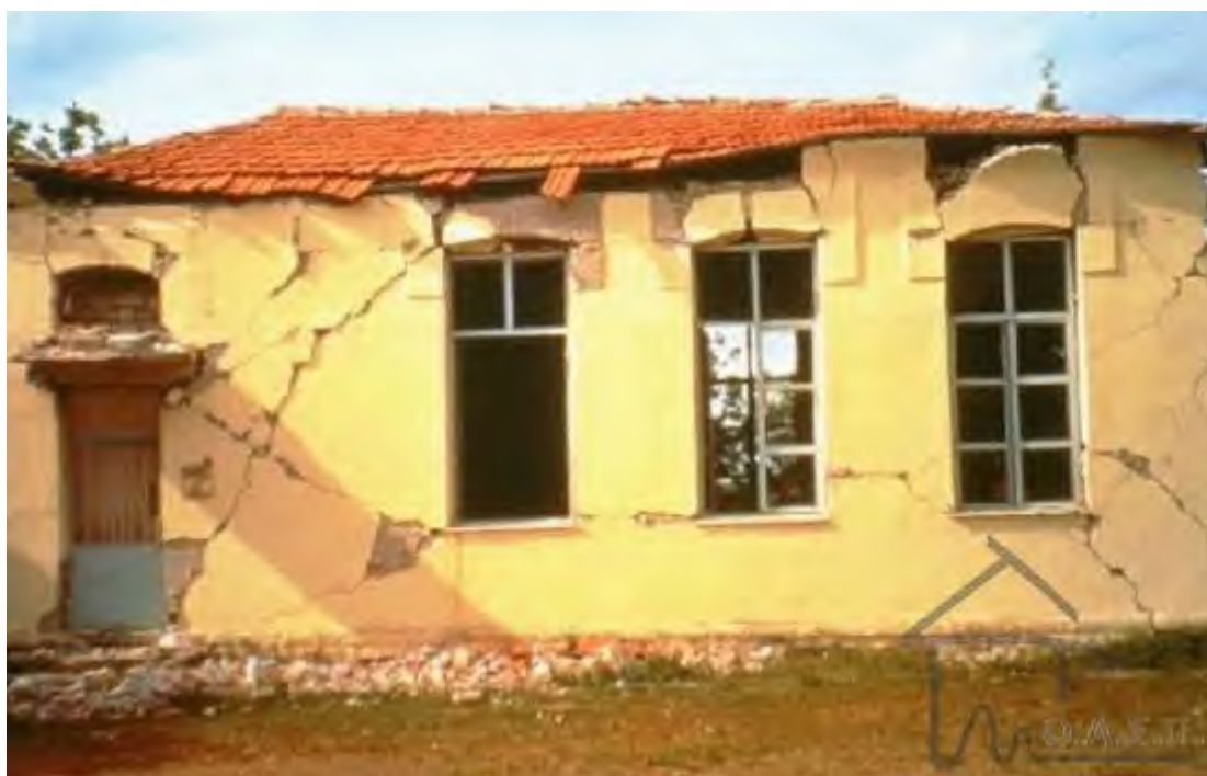
Φωτογραφία 5-1. Αστοχίες περί των ανοιγμάτων (πόρτες - παράθυρα) (Σεισμός 1995, Κοζάνη-Γρεβενά, πηγή: Φωτογραφικό αρχείο ΟΑΣΠ)
