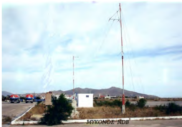
Ο Μη Κατευθυντικός Ραδιοφάρος (NDB - Non Directional Beacon) της Μυκόνου.
